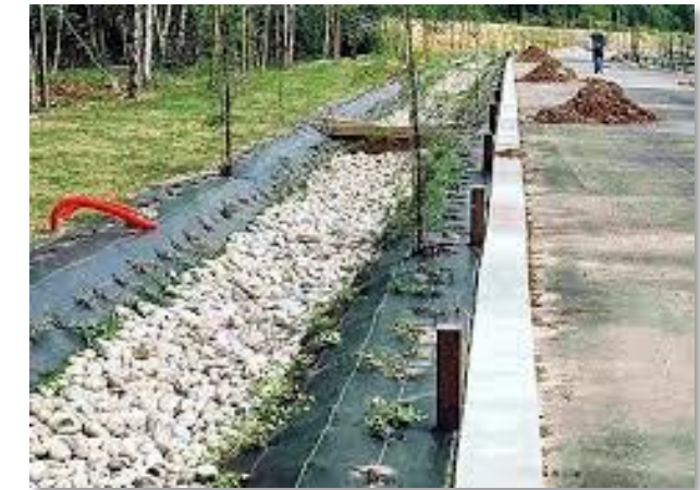
Noue plantée et filtrantes (sols imperméables)
